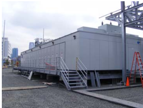
Fig. 23. 26 kV Switchgear (Outside)
