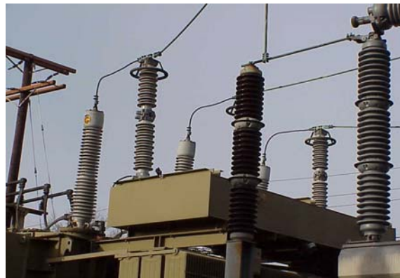
Fig. 22. 230 kV Lightning Arrester
